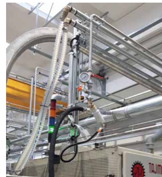
Gli impianti di rabbocco possono essere automatici o su chiamata operatore
